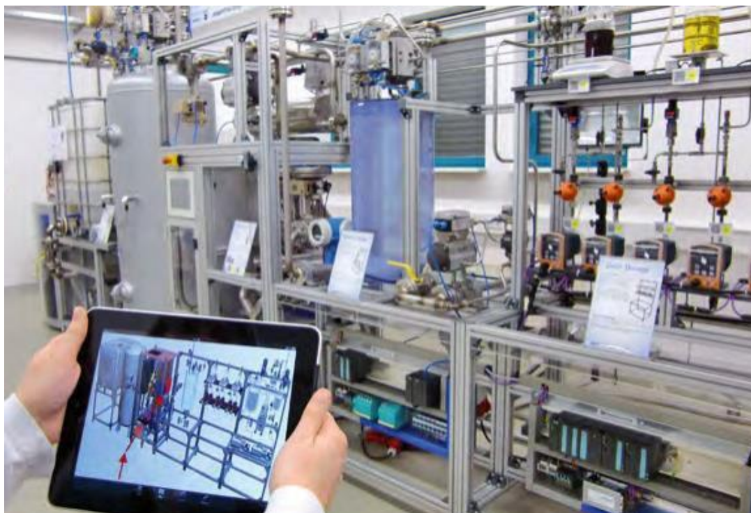
Fig. 1.7. Exemplu de utilizare a realității augmentate într-o instalație de fabricație automată [7]
